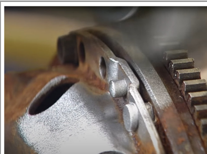
Éliminer la corrosion
